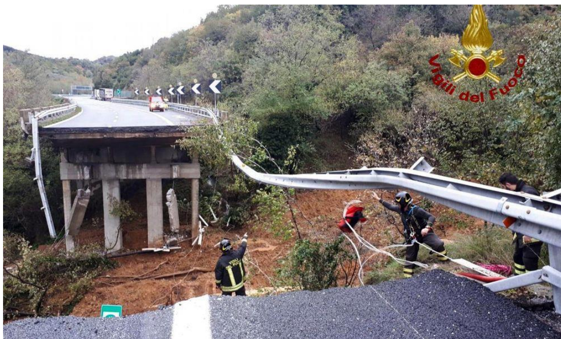
Obrázek 24: Zřícený most na dálnici A6 mezi Savonou a Turínem, 24. 11. 2019.
