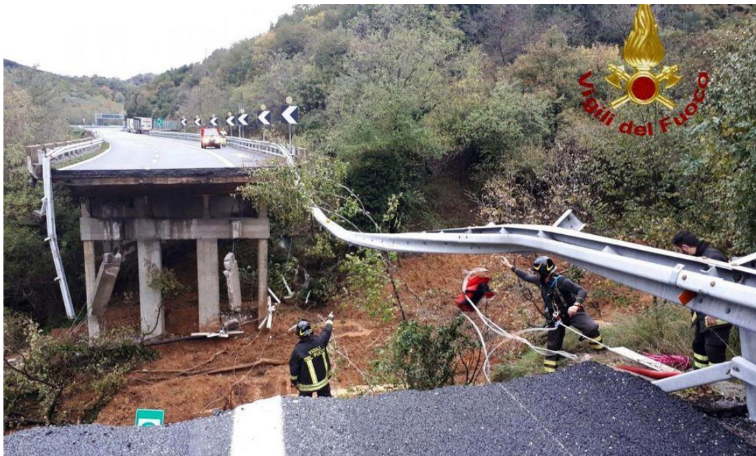
Obrázek 7: Zřícený most na dálnici A6 mezi Savonou a Turínem, 24. 11. 2019. [51]
